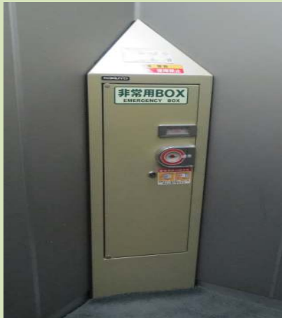
エレベーター内非常用BOX
